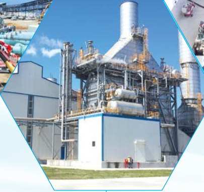
240 MW Doğalgaz Kombine Çevrim Santrali Projesi 2010
