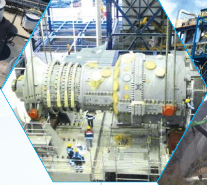
610 MW Doğalgaz Kombine Çevrim Santrali Projesi
